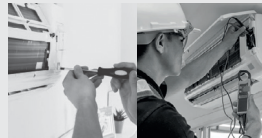
Ligação elétrica difícil
