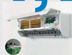
Abra o quadro elétrico e desconecte os motores dos ventiladores e as lâminas.
