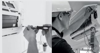
Difícil conexión eléctrica
