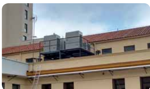
Residencia Mayores (Puertollano) Maxi MVD 2 tubos 156 kW
