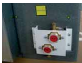
Purgadores en entrada y salida de agua.
