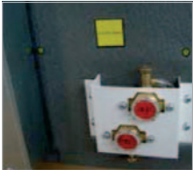
Purgadores en entrada y salida de agua
