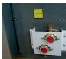
Purgadores en entrada y salida de agua
