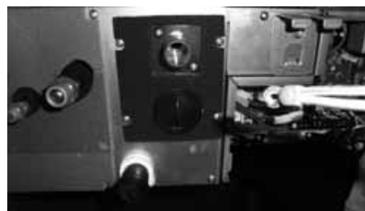
Toma de llenado para tests bomba
