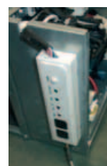
Detección de averías por LEDS
